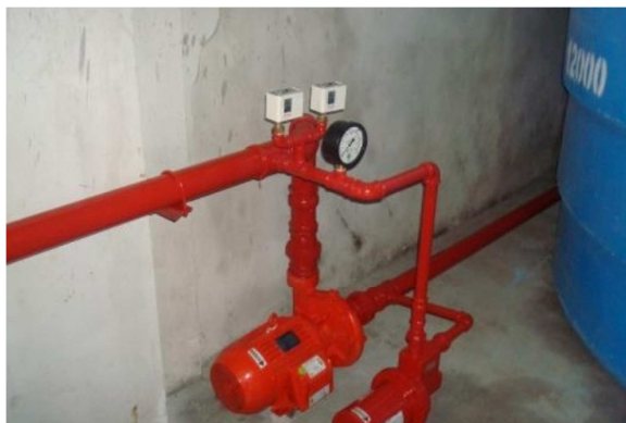
Figura 7 - Instalação bombas de incêndio
